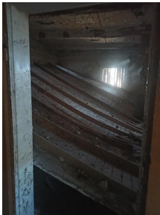
Rysunek 30 Zawalony sufit uniemożliwiający dostęp do w jednego z pomieszczeń.
