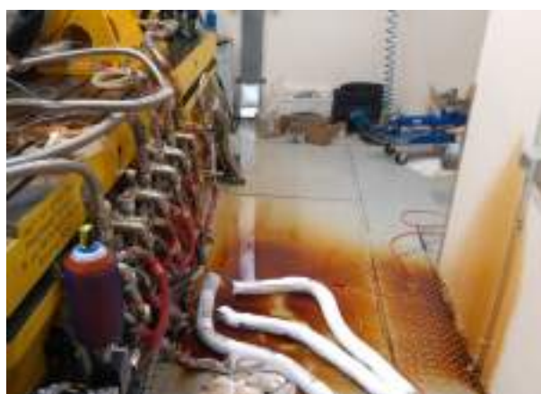
(a) Wyciek oleju spowodowany uszkodzeniem złączki
