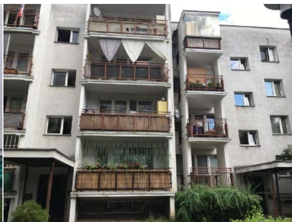
Fot. 6.25 Prowizoryczna ochrona przeciwsłoneczna, ochrona przeciwwłamaniowa na parterze oraz zabudowa balkonu na 3 piętrze. Budynek przy ul. Na Uboczu 18.
